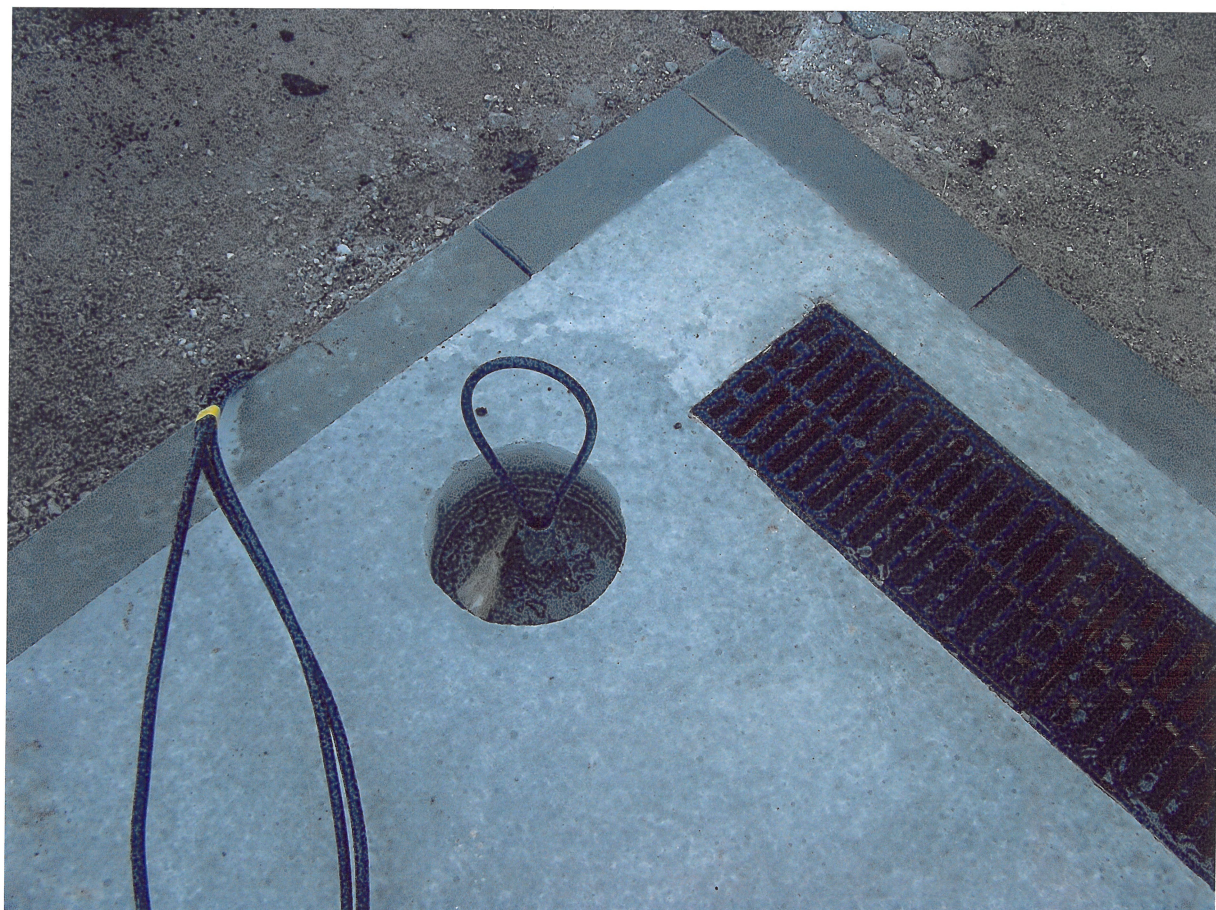
Foto archiwalne nr 2. Instalacje elektryczne – narożnik III
